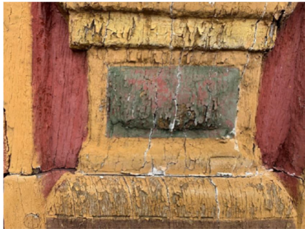
Abbildung 5: Schadensbild Lateinschule (Quelle: Kramp & Kramp 2023)
