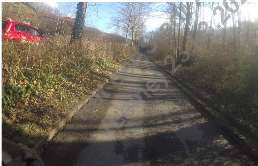
Abbildung 67: Beispiel für Sanierungsbedürftige Oberfläche am Walter-Gropius-Ring
